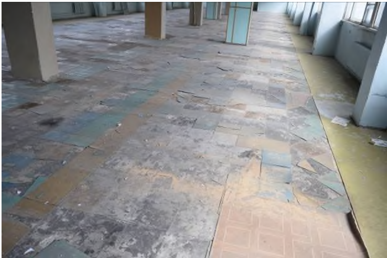
Фото А.11 – Разрушение покрытия пола из плиток линолеума
