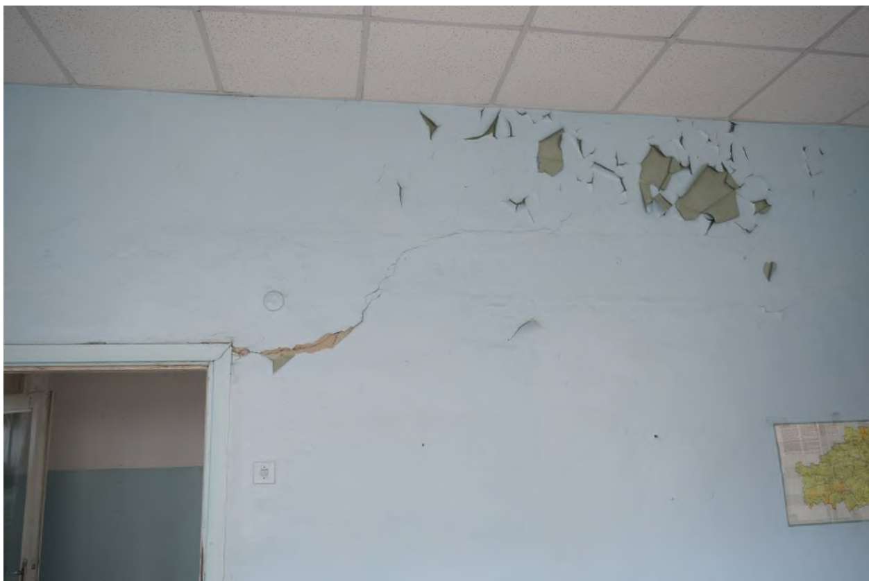
Фото А.10 – Сквозная трещина в перегородке в осях «А – Б», «10 – 11», отслоение отделочного покрытия
