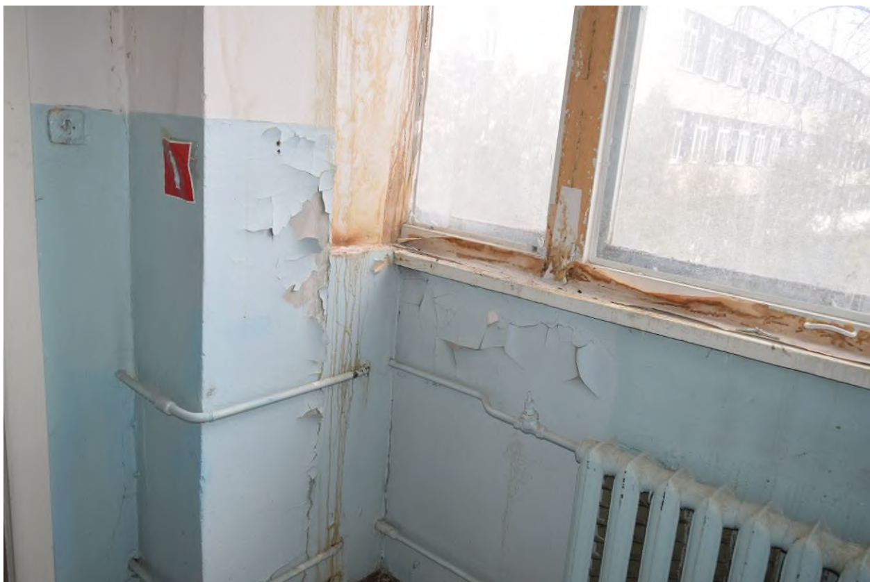
Фото А.6 – Следы увлажнения, отслоение отделочного покрытия колонны и стены в осях «Б», «11»
