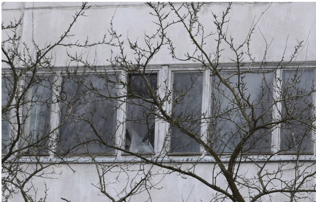
Фото А.15 – Трещины в ленточном остеклении по оси «В»
