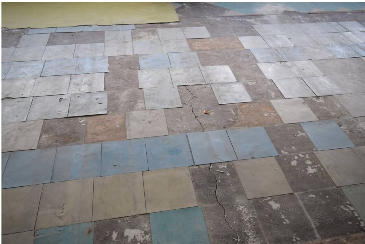
Фото А.12 – Разрушение покрытия пола из плиток линолеума, трещины
