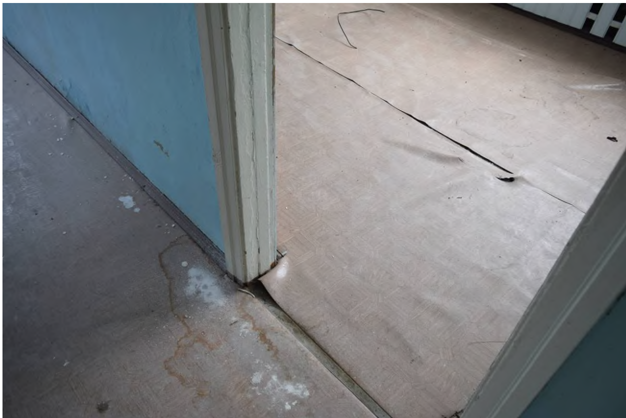
Фото А.13 – Разрушение покрытия пола из линолеума
