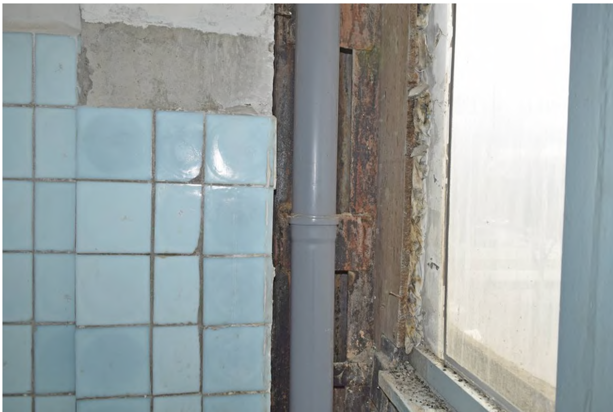
Фото А.7 – Разрушение лакокрасочного покрытия фахверковой колонны в осях «Б», «1», коррозия
