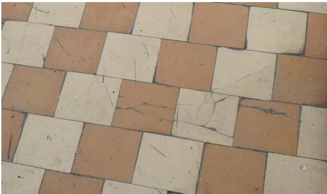
Фото А.14 – Трещины в полах с покрытием керамической плиткой
