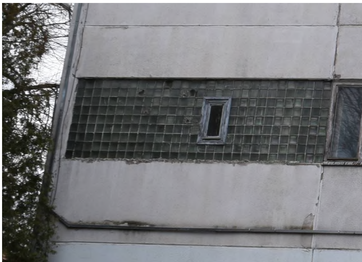
Фото А.16 – Трещины в остеклении стеклоблоков по оси «В»
