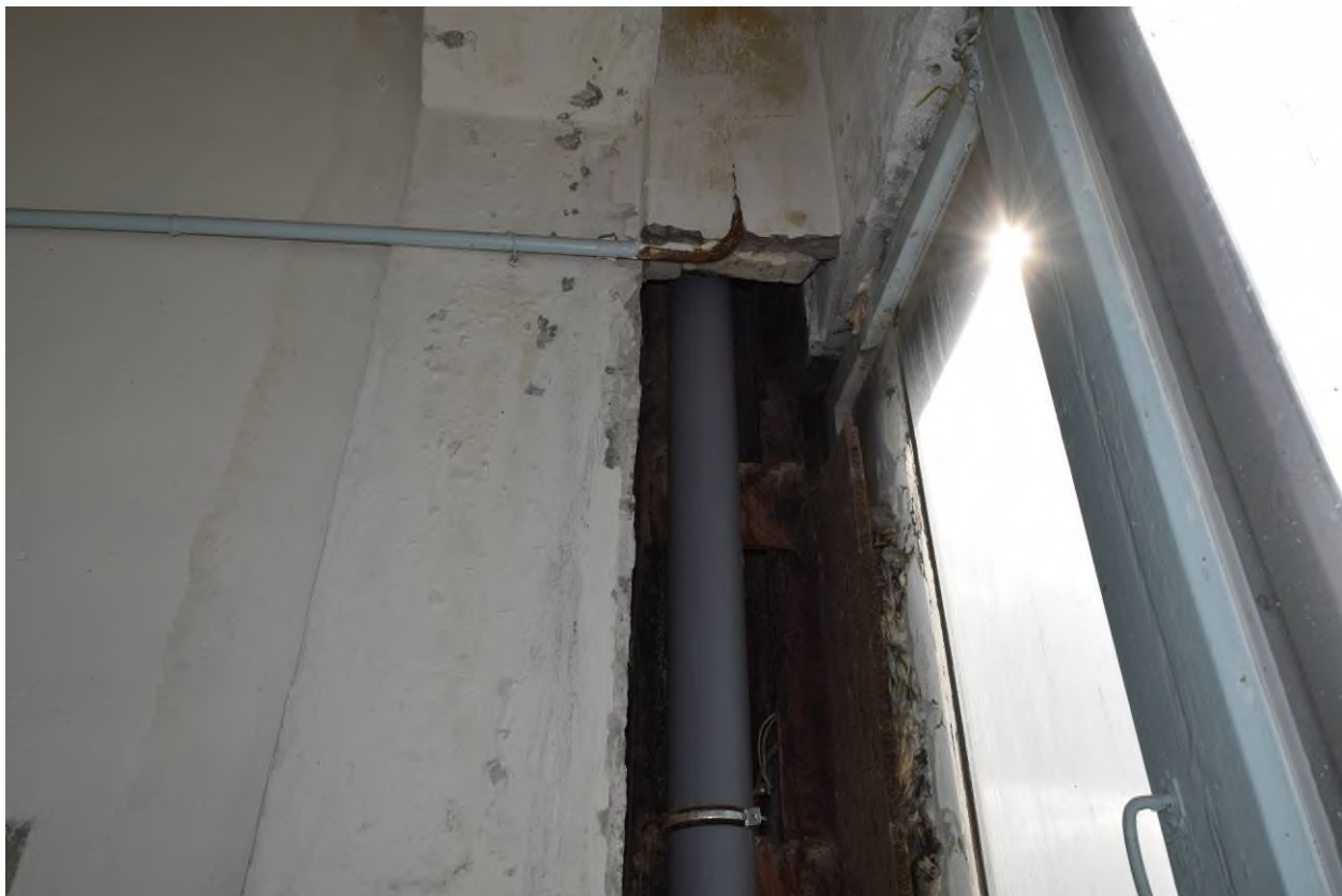
Фото А.5 – Следы увлажнения, отслоение отделочного покрытия колонны в осях «Б», «1»
