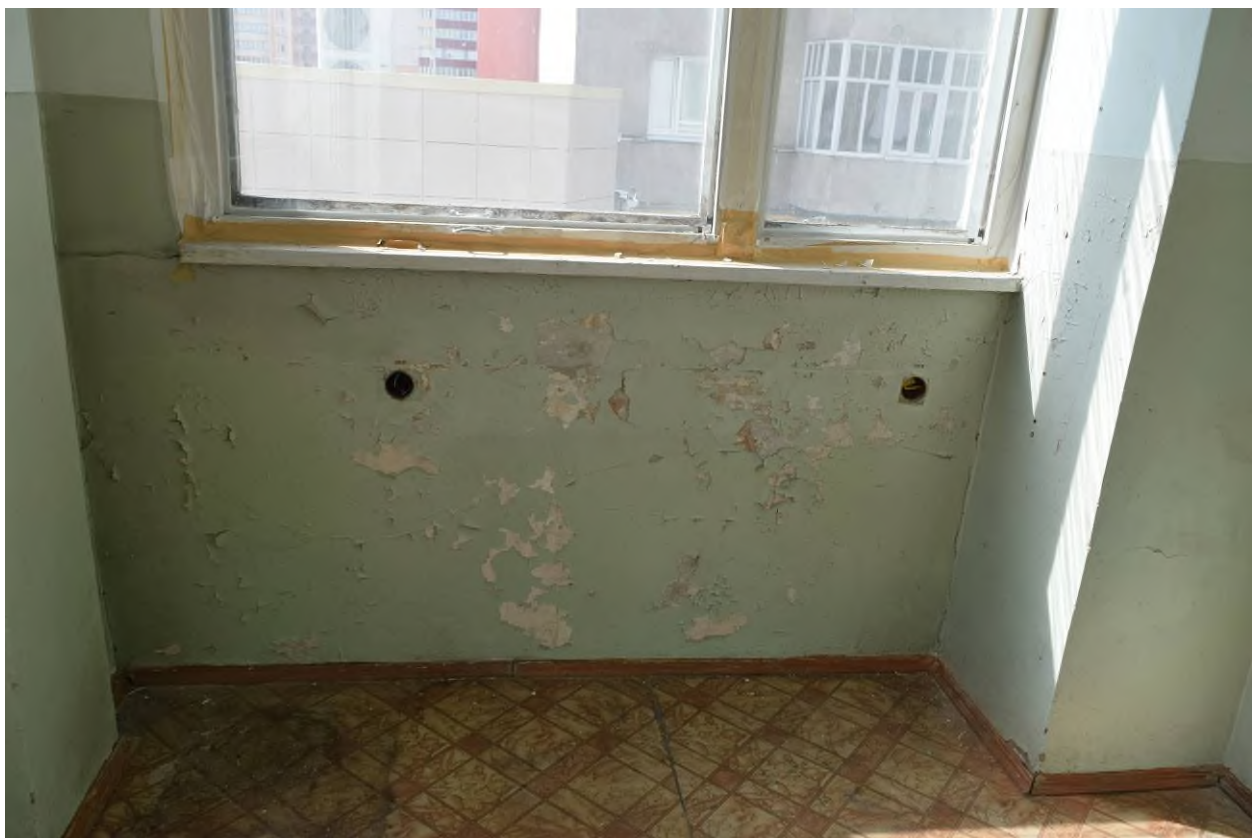
Фото А.9 – Отслоение отделочного покрытия стеновой панели внутри помещения по оси «1»
