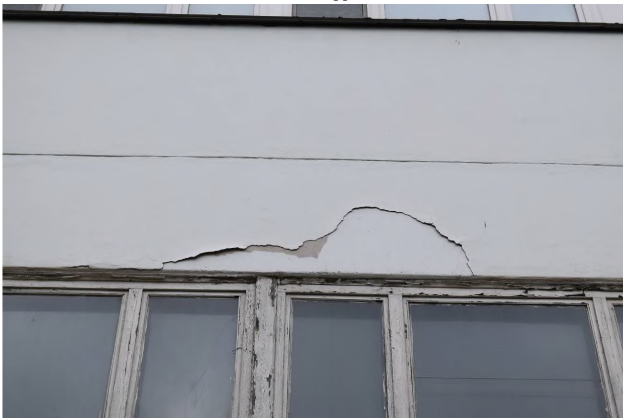
Фото А.8 – Отслоение отделочного покрытия стеновой панели снаружи помещения по оси «А»
